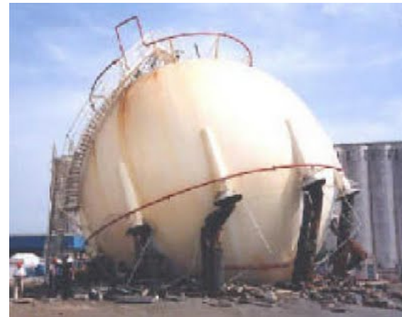
Collasso di un serbatoio sferico il test di tenuta idraulica a causa della corrosione del supporto
